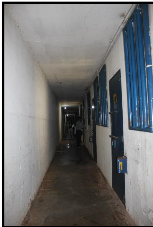
Figura 5 - Corredor das alas sem iluminação natural. Fonte: MNPCT.
