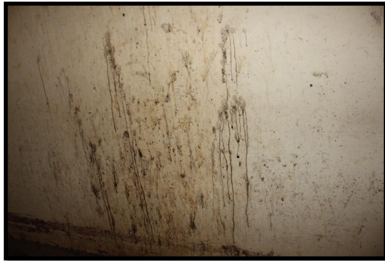
Figura 17 - Paredes sujas e deterioradas. Fonte: MNPCT.
