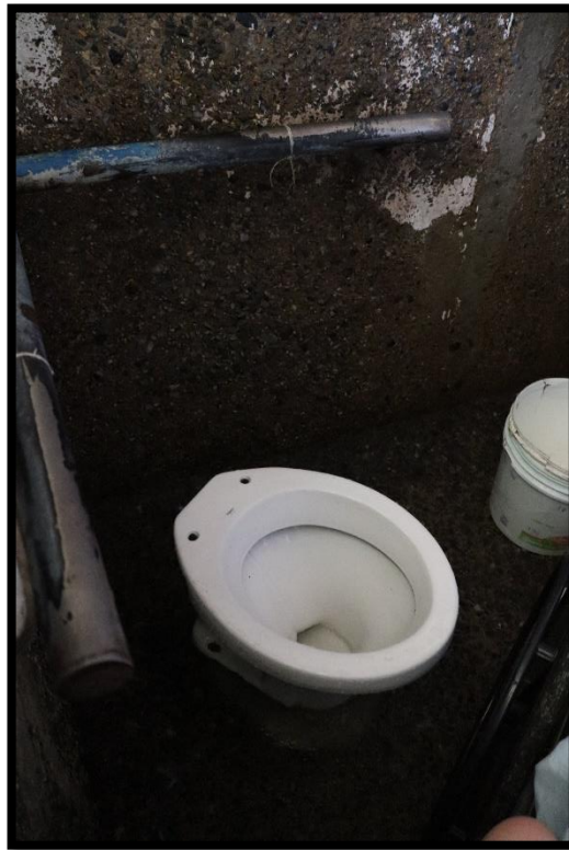
Figura 15 - Sanitário sem acessibilidade. Fonte: MNPCT.
