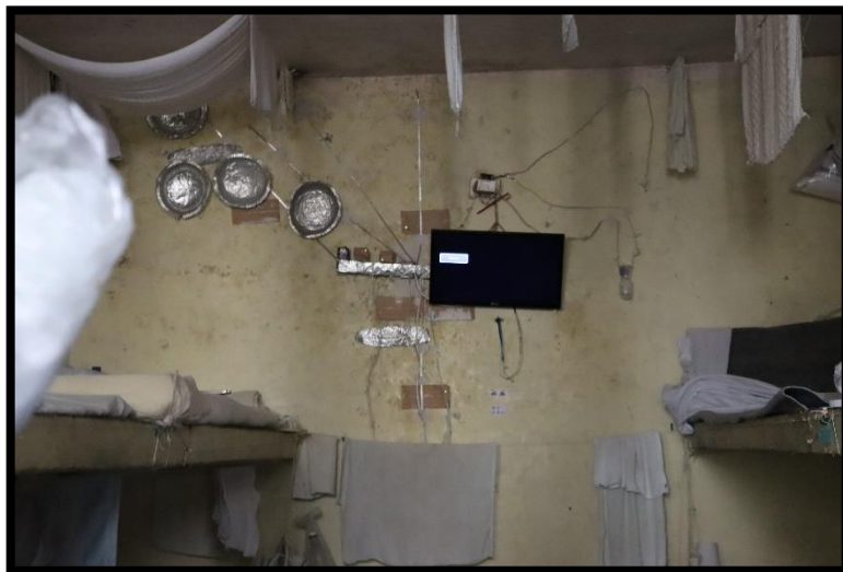
Figura 19 – Fiações improvisadas na cela. Fonte: MNPCT.
