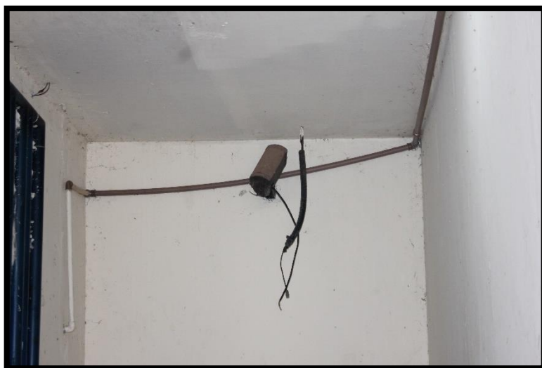
Figura 20 - Câmera de segurança desinstalada. Fonte: MNPCT.
