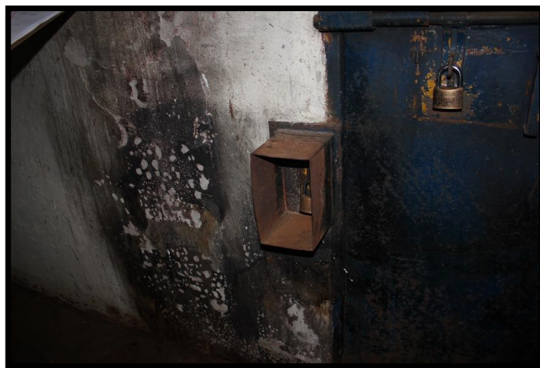
Figura 16 - Paredes sujas e deterioradas perto da porta da cela. Fonte: MNPCT.
