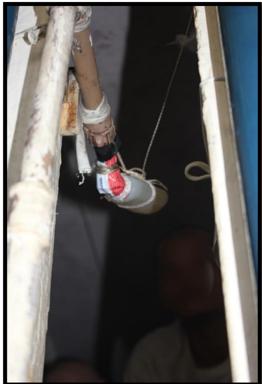
Figura 24 - Chuveiro improvisado. Fonte: MNPCT.
