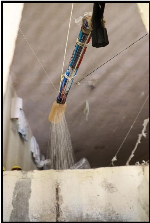
Figura 23 - Chuveiro improvisado. Fonte: MNPCT.
